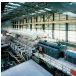
Site traditionnel accueillant la turbine d'une centrale électrique où des années d'expérience ont été acquises en travaillant dans les zones confinées et extrêmement propres.
