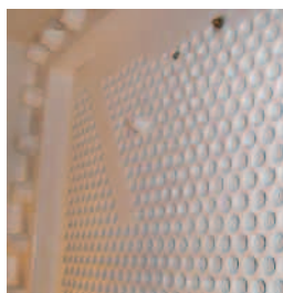
Plaque tubulaire d'un condensateur après traitement protecteur à base de fibre de verre.
